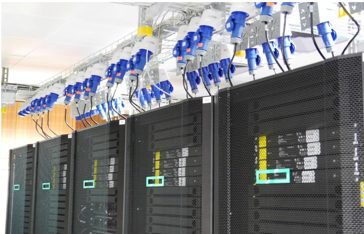
Abbildung 3: Der im Maschinenraum 1 installierte HPC-Cluster
