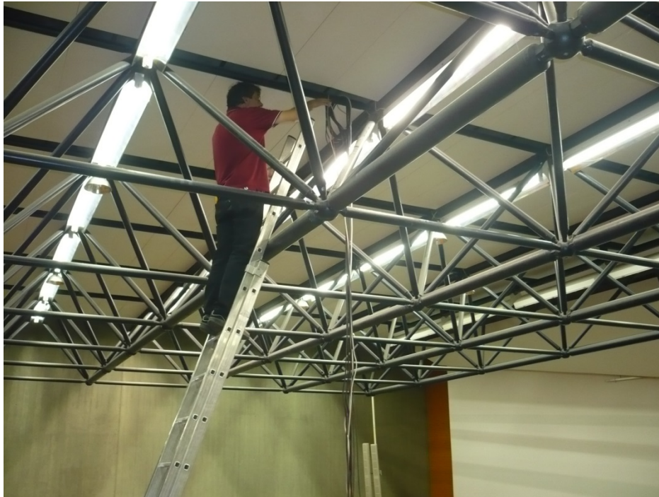
Abbildung 16: Beamerinstallation in einem Hörsaal der Chemie
