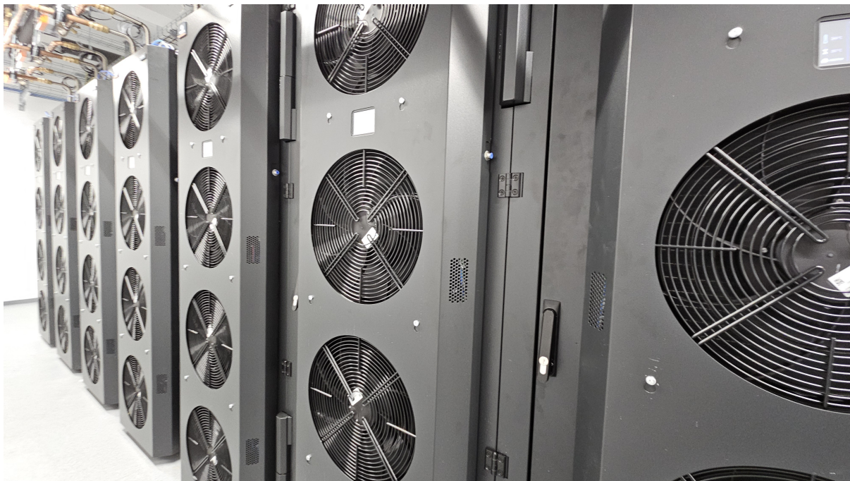
Abbildung 2: Besonders große Lüfter sowie Wasserkühlung im Maschinenraum 4
