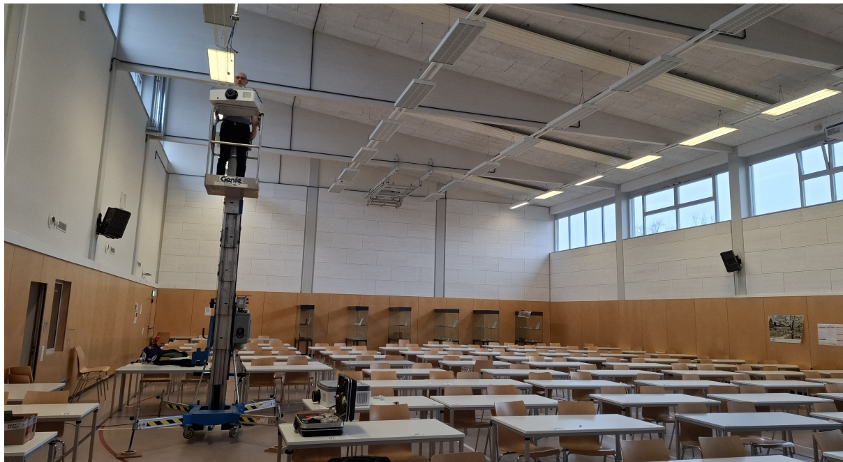
Abbildung 11: Projektorinstallation im Pabel-Hörsaal (Campus Hubland Nord)
