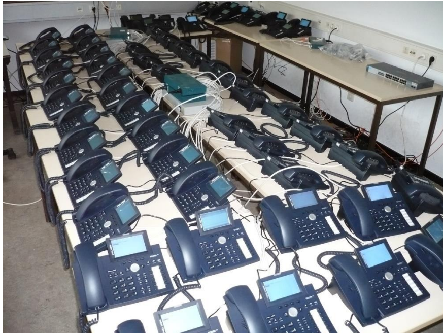
Abbildung 67: VoIP-Telefone im Testcenter des Rechenzentrums
