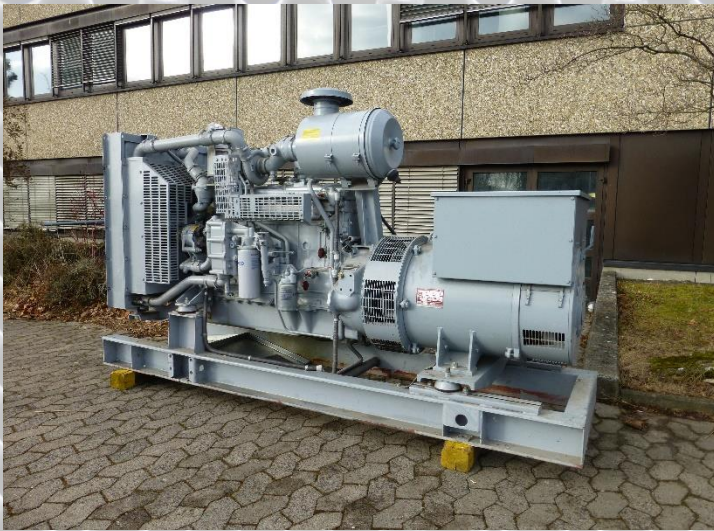
Abbildung 79: Ausgedieselt - die alte Notstromversorgung 2015
